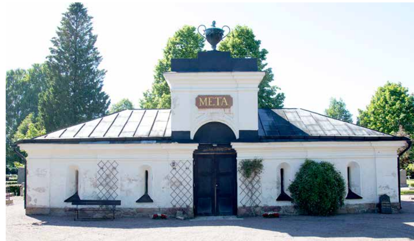
Det vackra kapellet har genomgått en omfattande renovering även utvändigt. Bland annat har fasaden fått tillbaka sin ursprungliga färg. Urnan på taket har också fått en uppsatsning.
