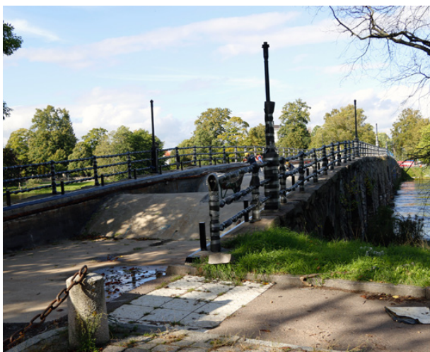
Ytskiktet byts bland annat ut denna gång. Utan det ser bron ut som en puckelpist.
