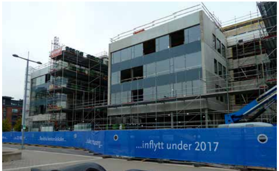
Det byggs och planeras på många ställen i Karlstad i år. Bland annat här, på Packhusgatan i Inre hamn. FOTO: ERIK BONDE
