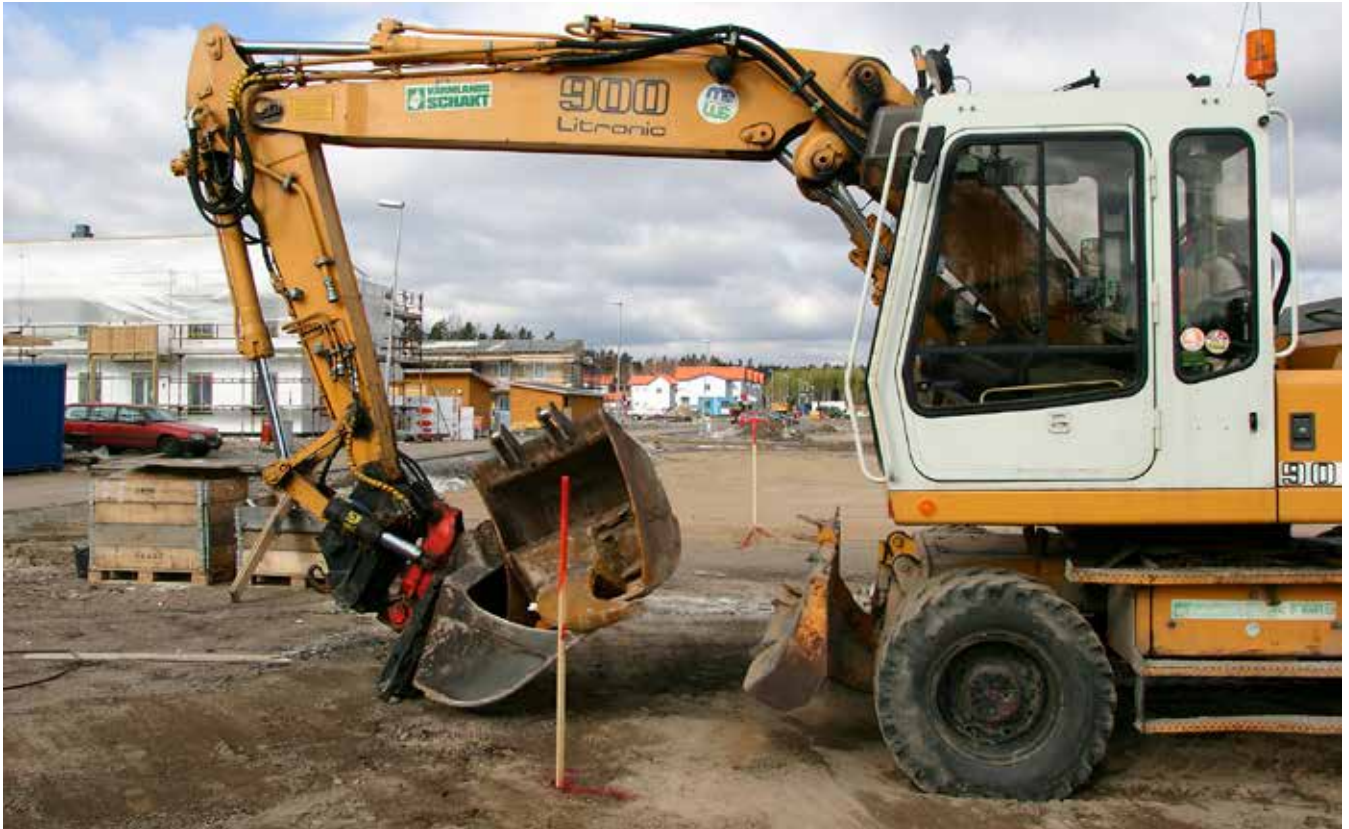
Målsättningen är att bygga 1 000 nya lägenheter per år i Karlstad. På bilden är arbetena i full gång i Södra Råtorpsområdet, där de första hyresgästerna redan flyttat in.
